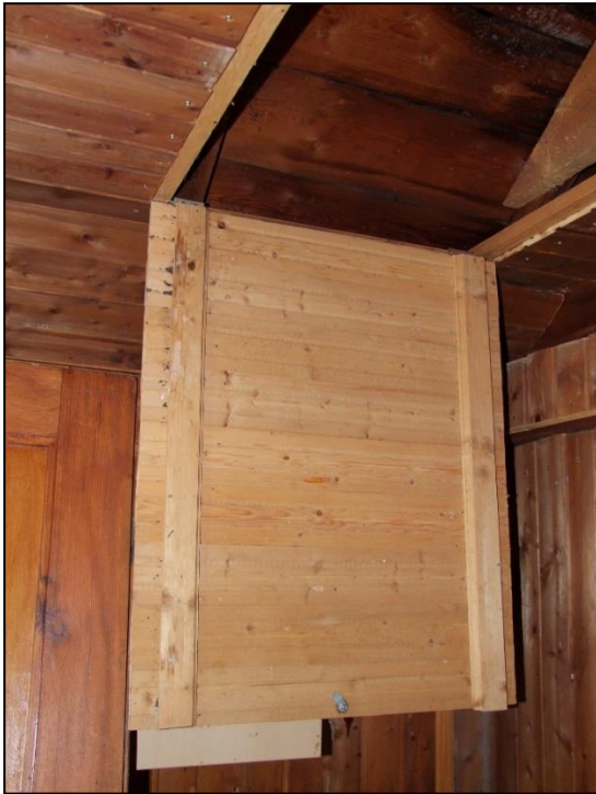
Abbildung 8: Dachbodenklappe mit Fledermauskot
