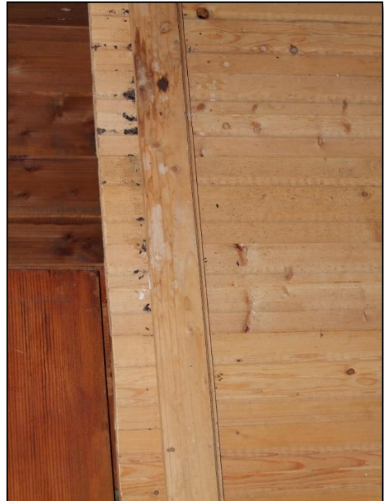
Abbildung 9: Dachbodenklappe mit Fledermauskot
