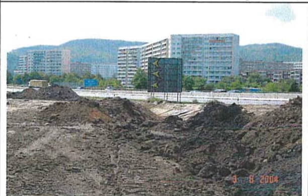
Aufgehaldeter kontaminierter Aushub
