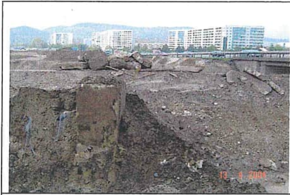
Separierte Betonteile am Baugrubenrand
