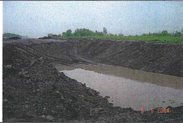
Angesammeltes Wasser in Baugrube am 06.05.04
